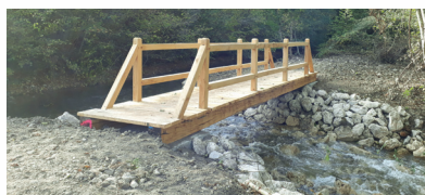
Arasement total clapet de Rocon (Coulanges)
